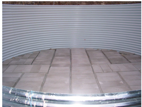
Photo 16 : Aération basse – Station Silo
